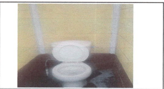
FOTO 6 Un inodoro en mal estado será sustituido.
