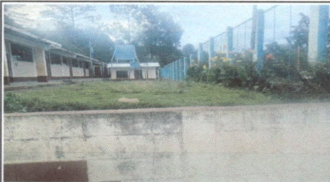
FOTO 3 Estado del muro perimetral del patio y jardín a mejorar.
