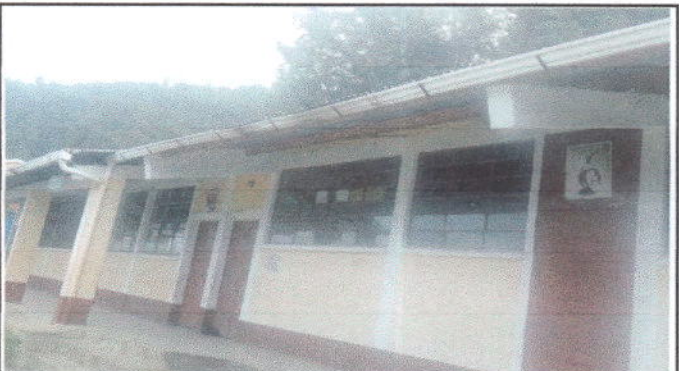
FOTO 4 Las canaletas a sustituir por estar en mal estado y de no tener la medida adecuada no captan el agua pluvial del techo.
